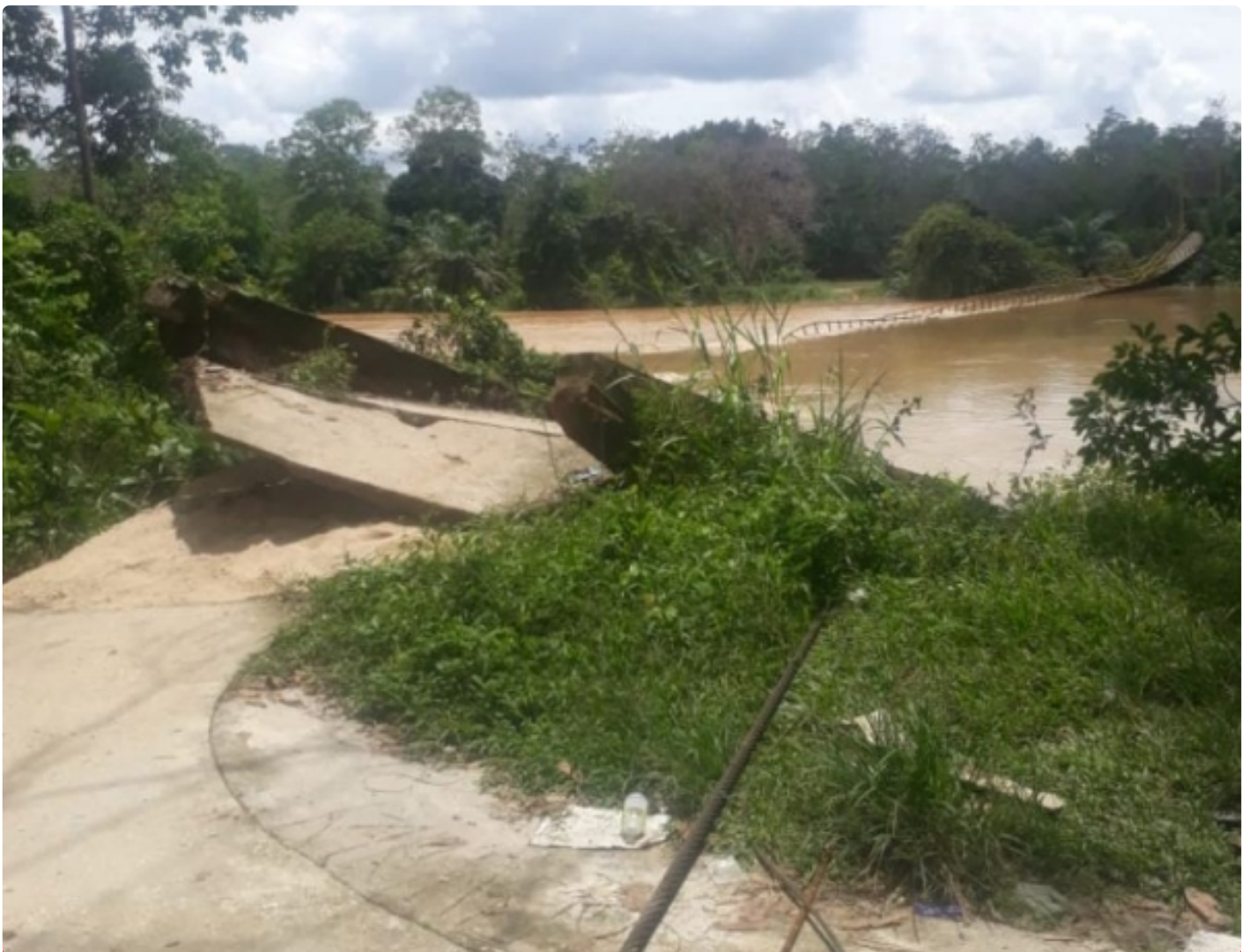
Jembatan Penyebrangan Ambruk
